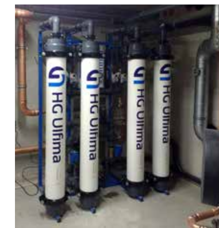
De Ultra Filtratie installatie van HG Ulfima in Hotel Jakarta.
